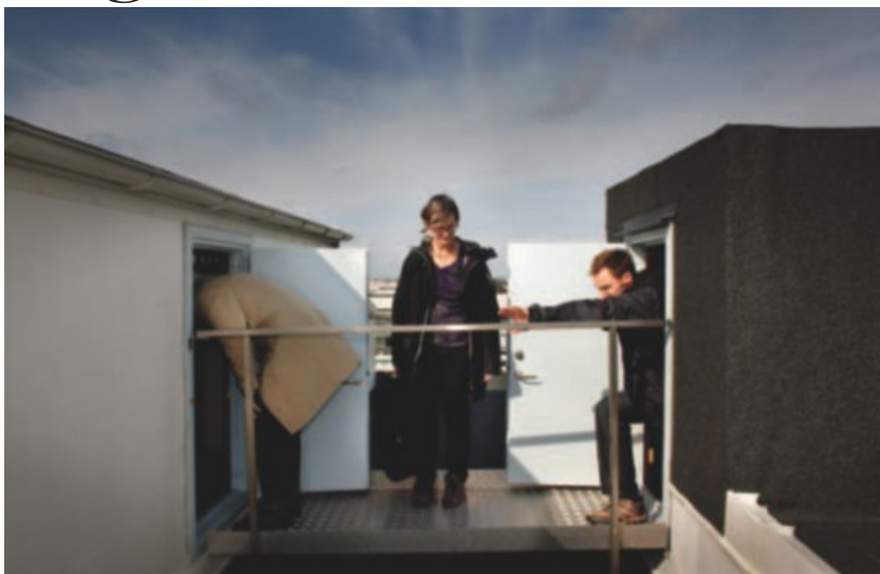
Miljötänk. Brf Hilda i Rosengård har renoverat miljonprojektshus och satsat på miljötänk. Guiden Johanna Ekne visar ventilationsrummet uppe på taket. Jesper Danielsson kliver ut på taket och Joachim Reiter kikar nyfiket in i ventilationsrummet.
