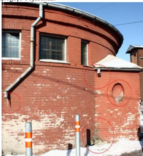
15.att. Sienas bojājums, noteku un loga trūkums
