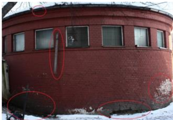
16. att. Noteku trūkums, mitruma ietekme uz pamatiem
