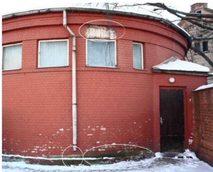
14.att. Ārsienas konstrukcija un redzami bojājumi
