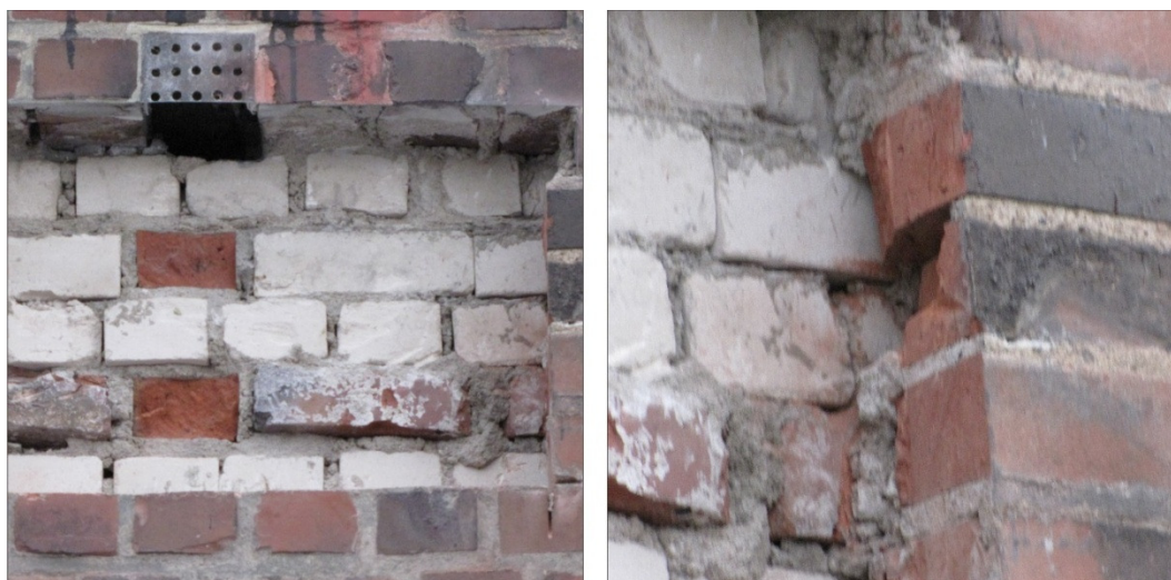
Abbildung 32 Ansicht Mauerwerksaufschluss im Bereich Passierzettel 1 – links: Lüftungsöffnung, rechts: direkter Anschluss des Hintermauerwerks an die Außenschale
