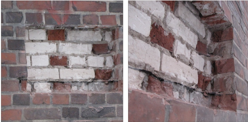
Abbildung 33 Ansicht Mauerwerksaufschluss im Bereich Passierzettel 4 – im linken Foto erkennbar sind regelmäßig angeordnete Binder zur Verbindung von Hintermauerwerk und Außenschale erkennbar, auch hier schließen beide Schalen nahtlos aneinander an (Foto rechts)
