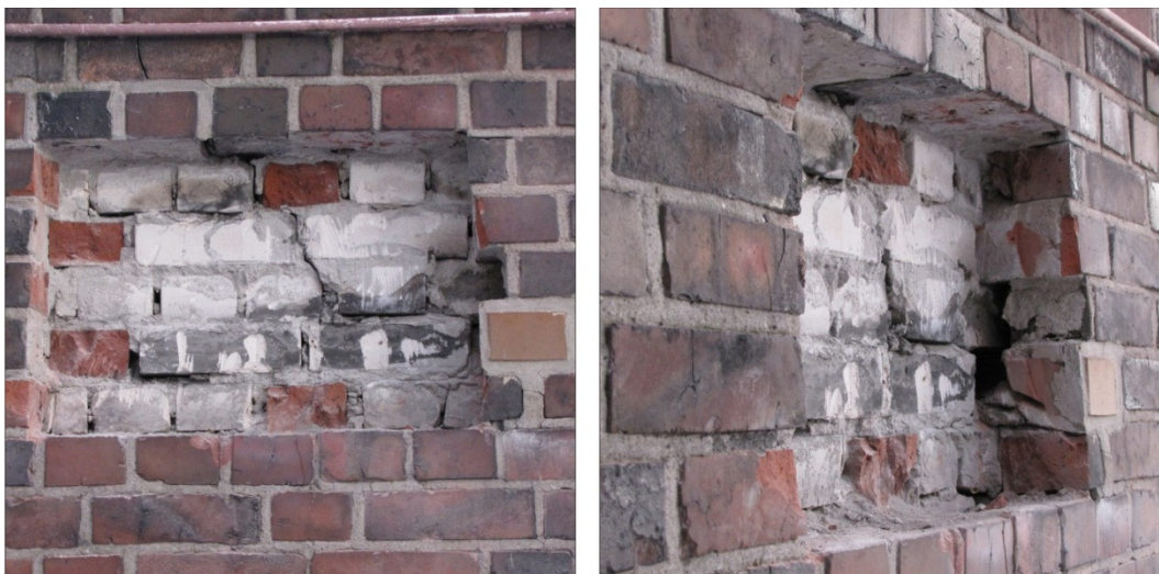
Abbildung 34 Ansicht Mauerwerksaufschluss im Bereich Passierzettel 9 – Der Mauerwerksaufbau entspricht im Wesentlichen dem der vorangegangenen Beispiele
