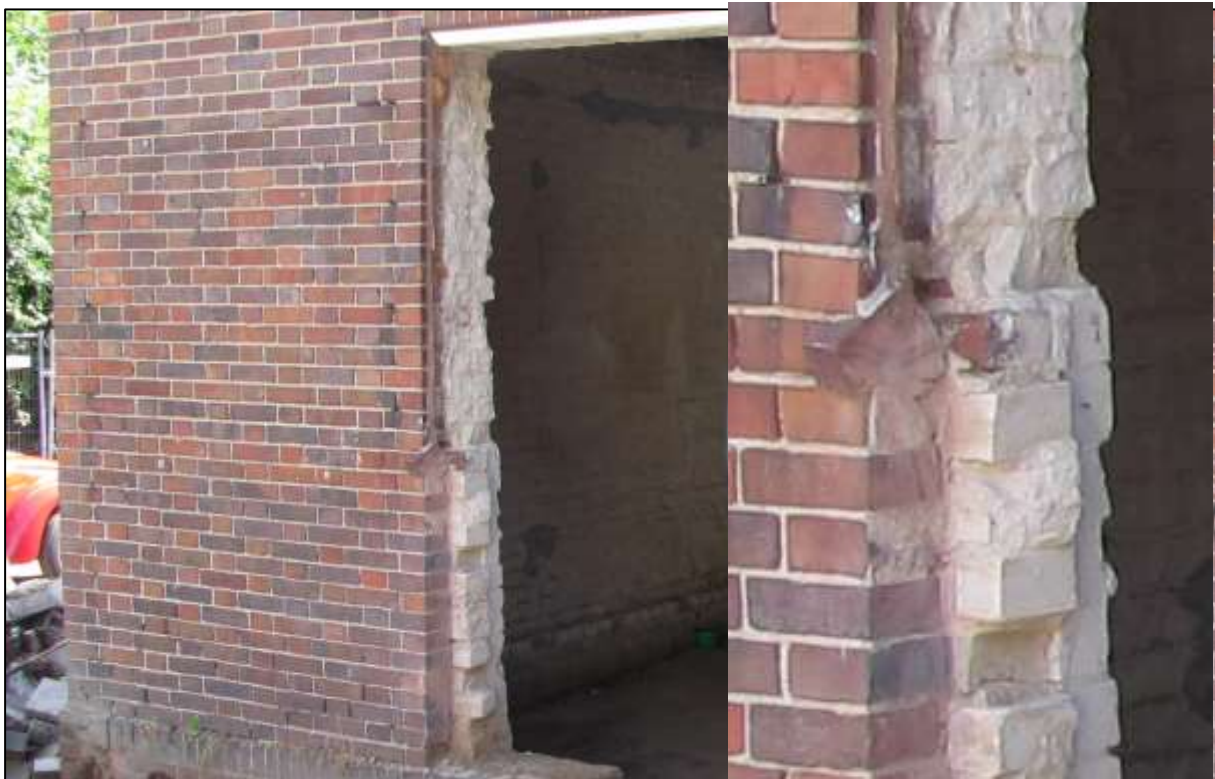
Abbildung 32 Ansicht Mauerwerk nach Entkernung und Einbringen der Öffnung für die künftigen Terrassentüren
