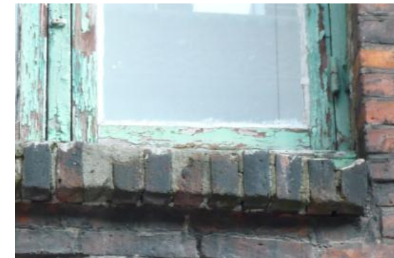
Abgeplatzte Farbe am Fenster- rahmen und starke Verschmutzung der Sohlbank
