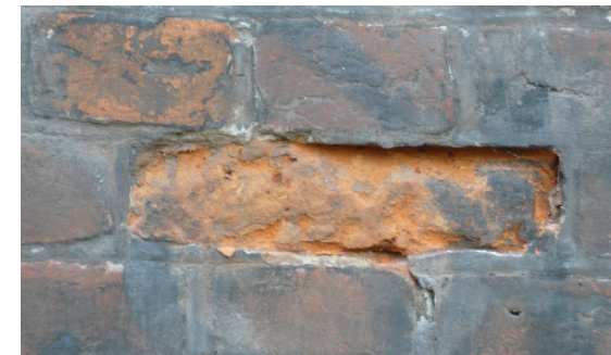
Schmutzpartikel und Abplatzung am Backsteinmauerwerk
