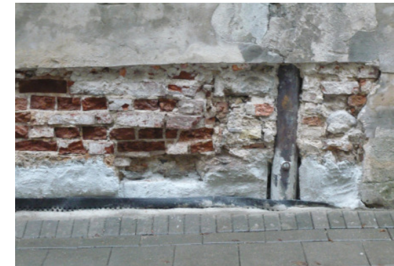
Massiver Schaden durch aufsteigende Feuchte und salzhaltiges Spritzwasser
