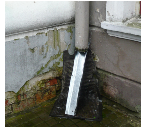
Feuchteschaden am Sockel
