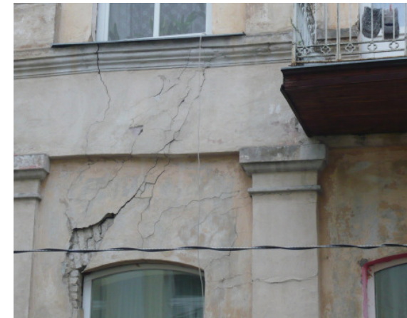
Durch Risse und Abplatzungen geschädigter Außenputz
