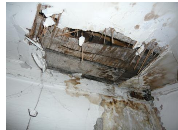
Massiver Wasserschaden an Holzbalkendecke
