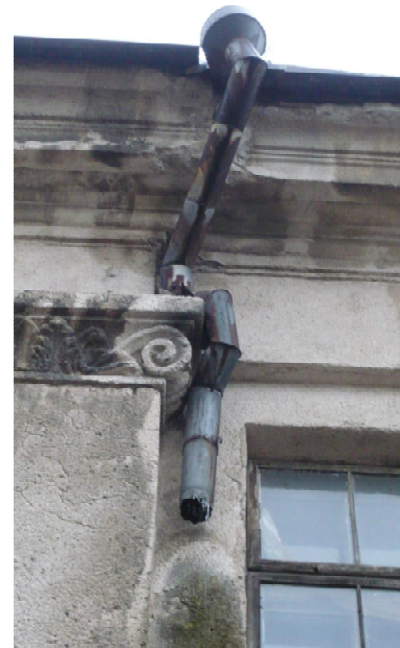
Wasserschaden durch fehlendes Fallrohr
